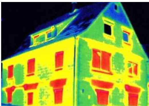
la termografia mette in evidenza la grande perdita di temperatura (superficie rossa) in corrispondenza dei cassonetti non coibentati al piano inferiore
